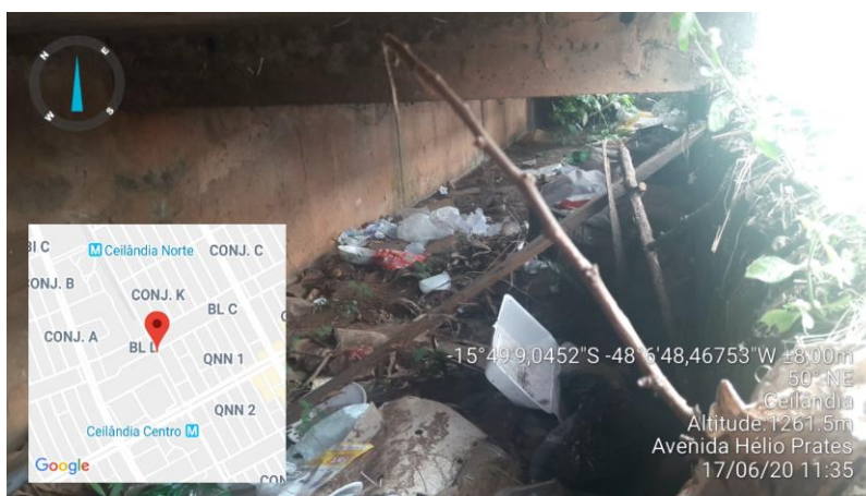
Figura 13 – Exemplo de resíduos sólidos dentro dos dispositivos de captação (Bocas de Lobo)
