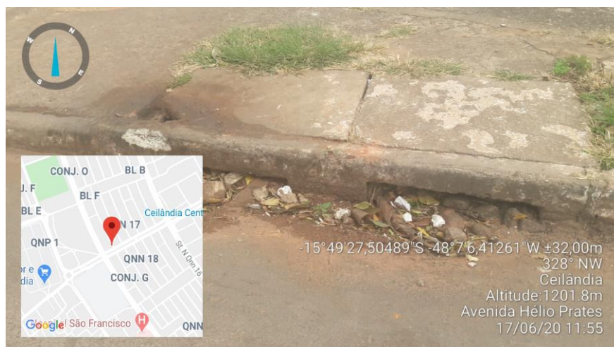
Figura 14 - Exemplo de obstrução dos dispositivos de captação (Bocas de Lobo)
