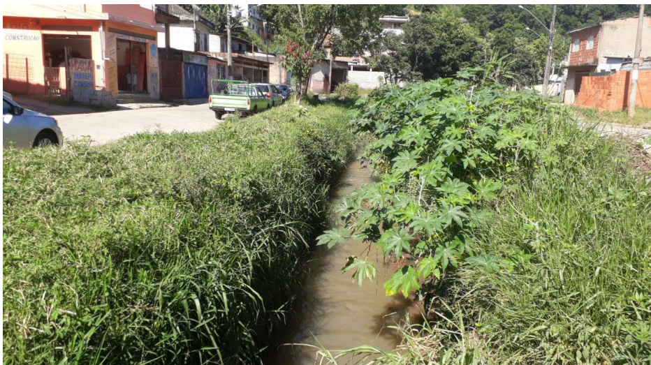
Figura 6 Canal em Gabião sem manutenção.
