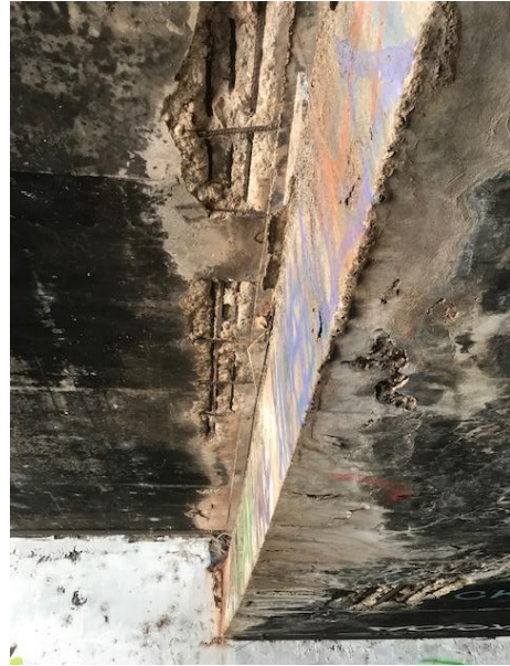
Figura 23 – Vista inferior do encontro da passarela Leste (esquerda) com a Oeste (direita)
