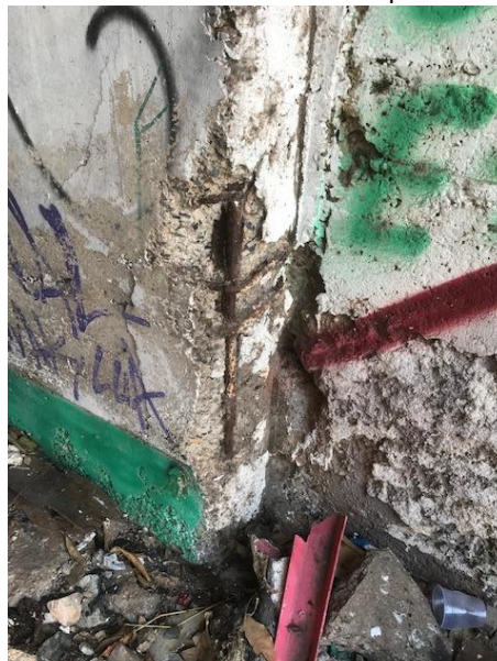
Figura 19 – Detalhe da armadura do pilar corroída
