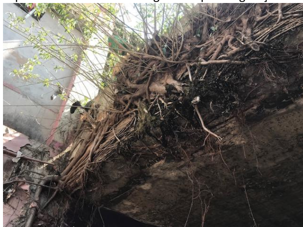
Figura 17 – Detalhe da vista inferior da laje da passarela Oeste sendo degradada pela vegetação
