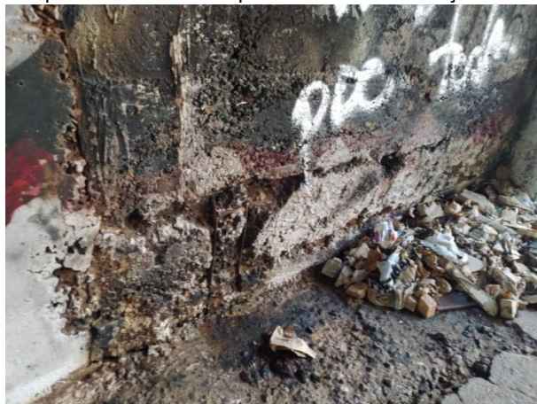
Figura 21 – Detalhe do muro de contenção da passarela Oeste em processo de deterioração
