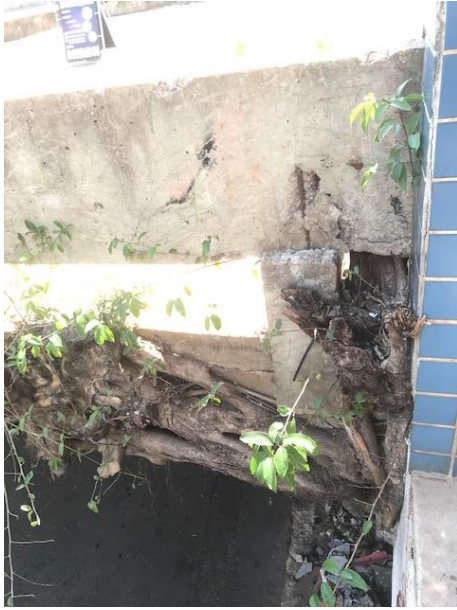
Figura 10 – Detalhe da vegetação degradando a estrutura da passarela Oeste
