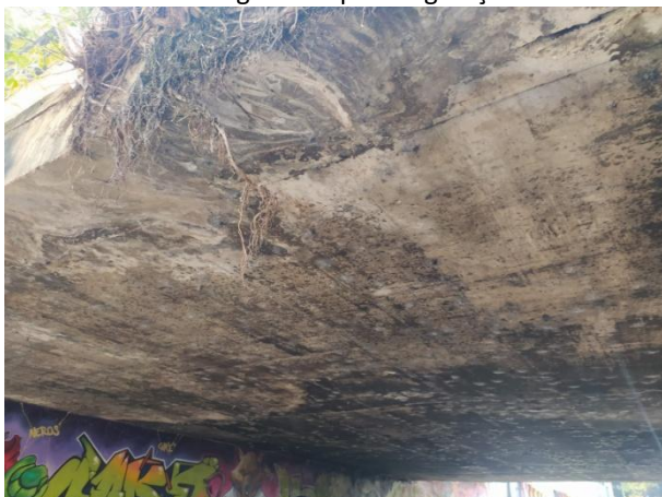
Figura 16 – Vista inferior da laje da passarela Oeste sendo degradada pela vegetação
