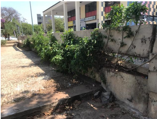
Figura 12 – Vegetação degradando a estrutura das passarelas
