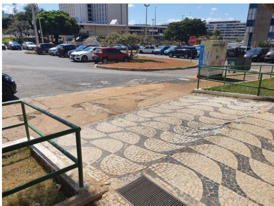
Figura 1 – Calçadas antigas e degradadas
