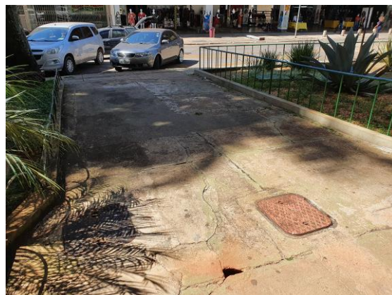
Figura 2- Calçadas antigas e degradadas
