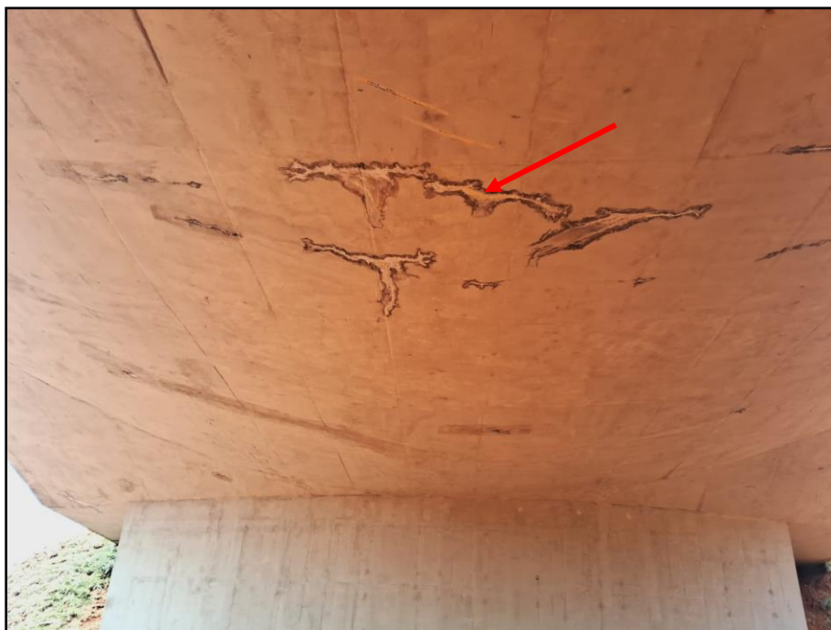
Figura 6 – Trincas na laje inferior do tabuleiro OAE
