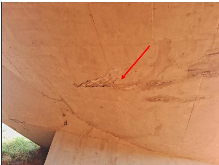
Figura 5- Trincas na laje inferior do tabuleiro OAE
