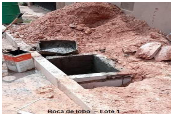
Boca de lobo – Lote 1
